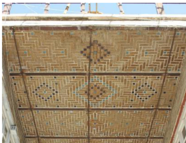
تصویر ۱۴. شیوه‌های متنوع آجرچینی سقف ترکیبی با آجر لعاب‌دار؛ پاساژ امجدی قم.
